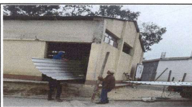
Foto 4: Resguardo de materiales en la bodega
