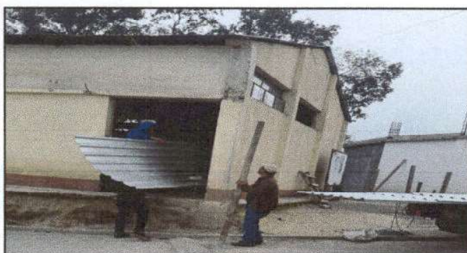
Foto 3: Resguardo de materiales en la bodega
